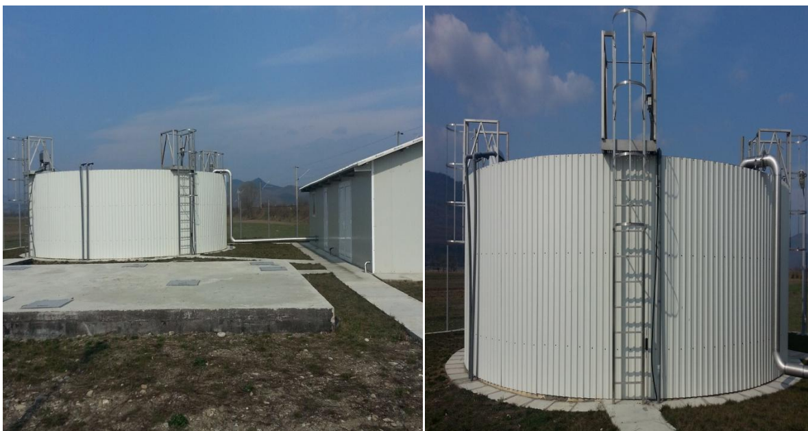
Stație de epurare Păltinoasa – finanțare F.E.A.D.R Măsura 322
